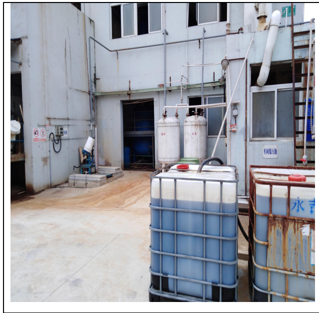
图5.1-4 叔丁基二甲基氯硅烷车间B
